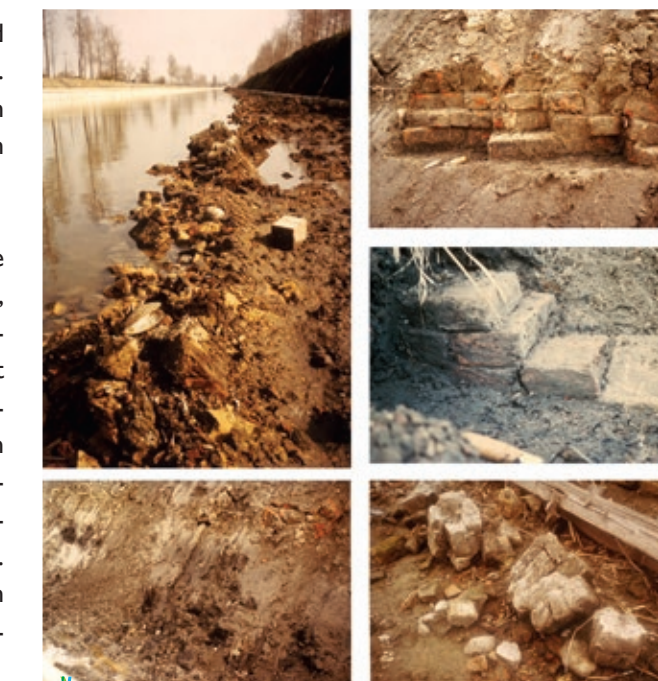
Bij onderhoudswerken aan de Damse Vaart in de jaren '80 van de 20ste eeuw zorgde het verlaagde waterpeil ervoor dat de restanten van het doorgraven Monnikerede kortstondig zichtbaar waren (foto's: © Bieke Hillewaert).
